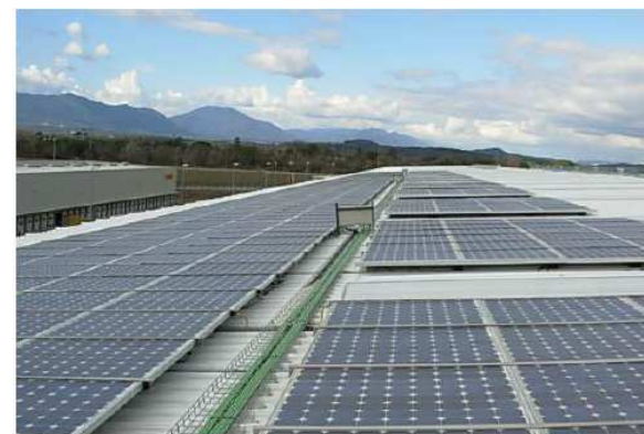
Plaques fotovoltaïques a Nau 3 del CIM La Selva
