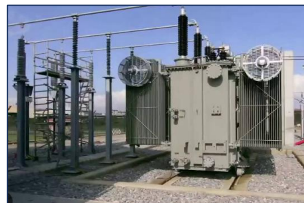
1 Subestación y red.
