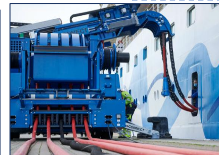
4 Sistema de gestión de cables
