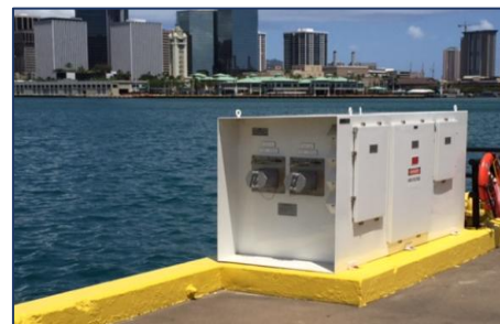
3 Cajas de conexión en bordemuelle
