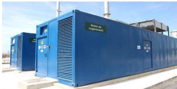
MOTORS DE COGENERACIÓ
