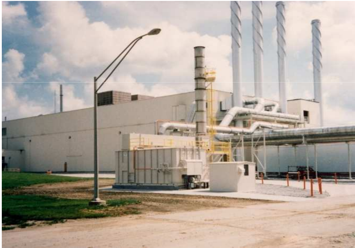
Sistema oxidación térmica recuperativa para 25.000Nm 3 /h
