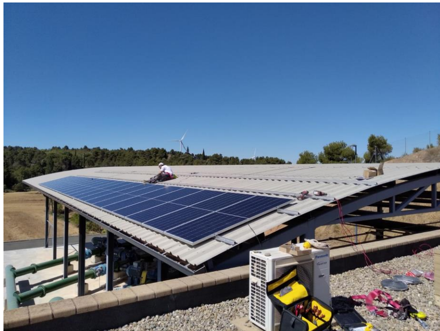
Instal·lació d'energies renovables fotovoltaics Comunitat de Regants de Garrigues sud
