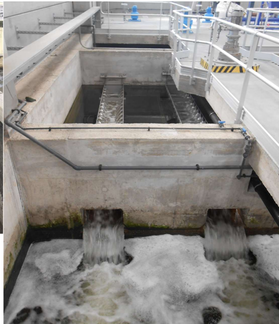
FILTRACIÓ PER DECANTACIÓ (ACTIFLO®)
