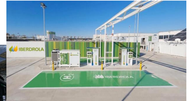
Primera instal·lació comercial certificada i en operació de producció i dispensació d'hidrogen renovable d'Espanya. Cotxeres TMB-Zona Franca
