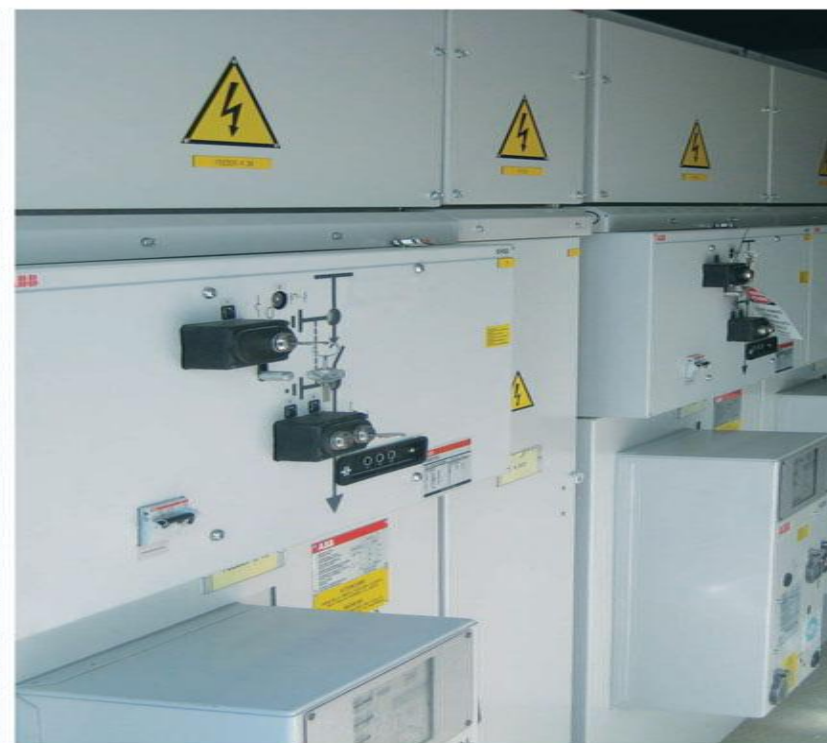
Celdas de media tensión
