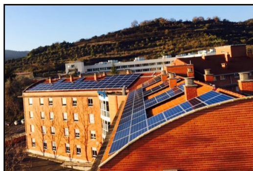
Residència 3a edat 45kWp
