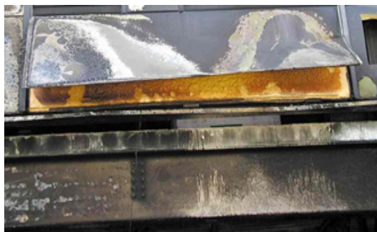
Figura 2.13. Imatge de delaminació d'un plafó sandvitx amb ànima de poliuretà durant un incendi a l'hospital Wharfedale, a Otley, West Yorkshire, Anglaterra, l'any 2003. Font: International Fire Protection.
