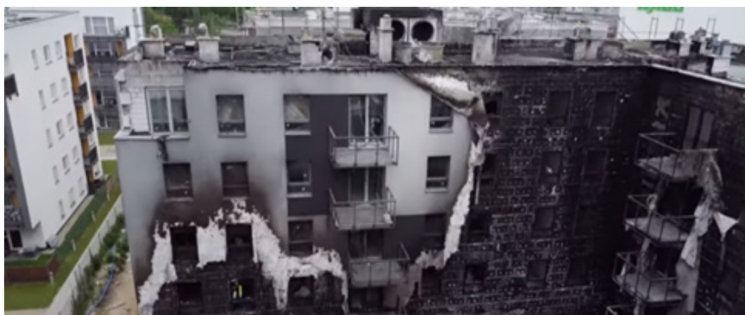
Figura 2.14. Incendio de fachada con sistema SATE de material aislante sin determinar. Edificio Belleville, Breslavia, Polonia, 19.05.2017.
