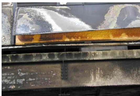
Figura 2.13. Imagen de delaminación de un panel sándwich con alma de poliuretano durante un incendio en el Hospital Wharfedale, Otley, West Yorkshire, Inglaterra, 2003. Fuente: International Fire Protection.
