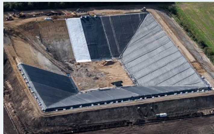
Estanques de almacenamiento
