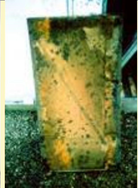
Aïllament fibrós contaminat a l'interior d'un sistema de renovació d'aire
