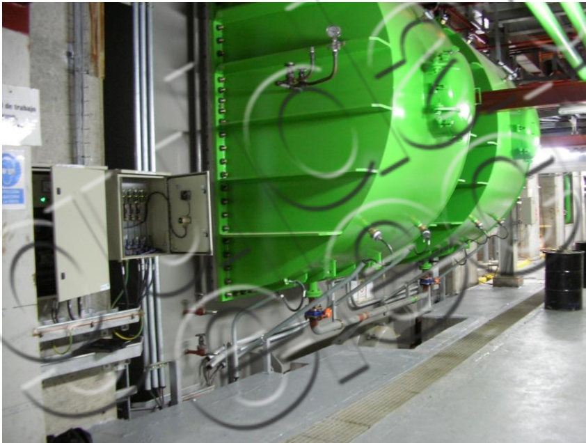
PC interna de condensadors
