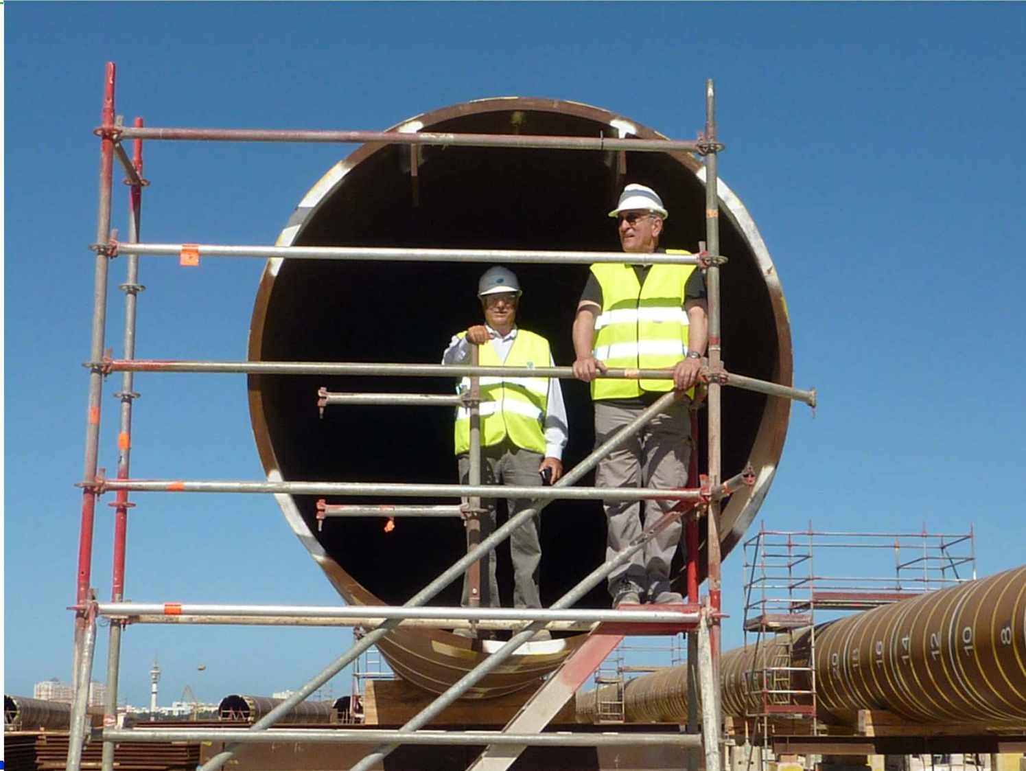
Almacenamiento Subterráneo de Gas Natural
